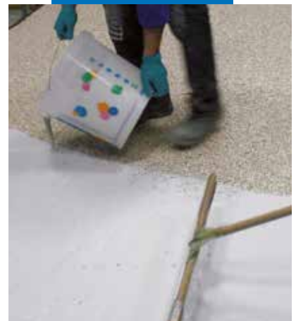
Auftragen von Ultratop auf den vorbereiteten Untergrund mit natürlichen Zuschlägen und Mapefloor I 910
